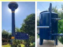
ระบบประปาบาดาล
