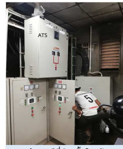
อุปกรณ์ที่ติดตั้งในห้อง
